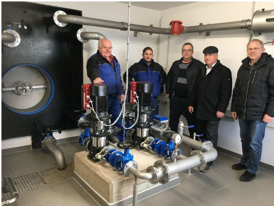
v. l. Wassermeister Frank Fröhlich, stv. Wassermeister Manuel Bruns, Frank Ruckes und Georg Schwehn (IG Hof) sowie Bauleiter Christian (Firma Müller) in der Pumpstation des neuen Vorlaufbehälters
